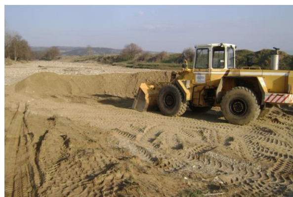
Εικόνα 6.13. Απόληψη εδαφικού υλικού στις 17-2-2012 στο ρέμα της Ανάληψης.
