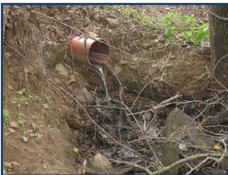
Εικόνα 6.10. Αγωγός απόρριψης αστικών λυμάτων στην Δορκάδα.
